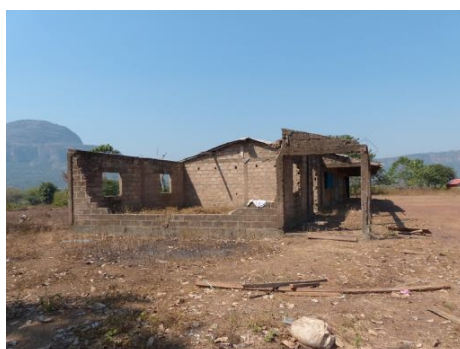
Vue de la partie effondrée du bâtiment depuis le chantier BTCS
